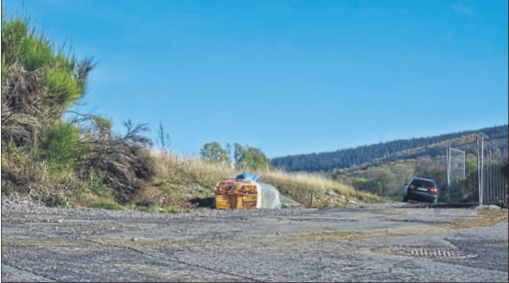
Der Asphalt im Jomendorfer- und Reichenberger Weg ist noch nicht richtig kalt“, da soll es im nächsten Jahr schon geradeaus weitergehen – mit der Verlängerung des Siepener Weges.
