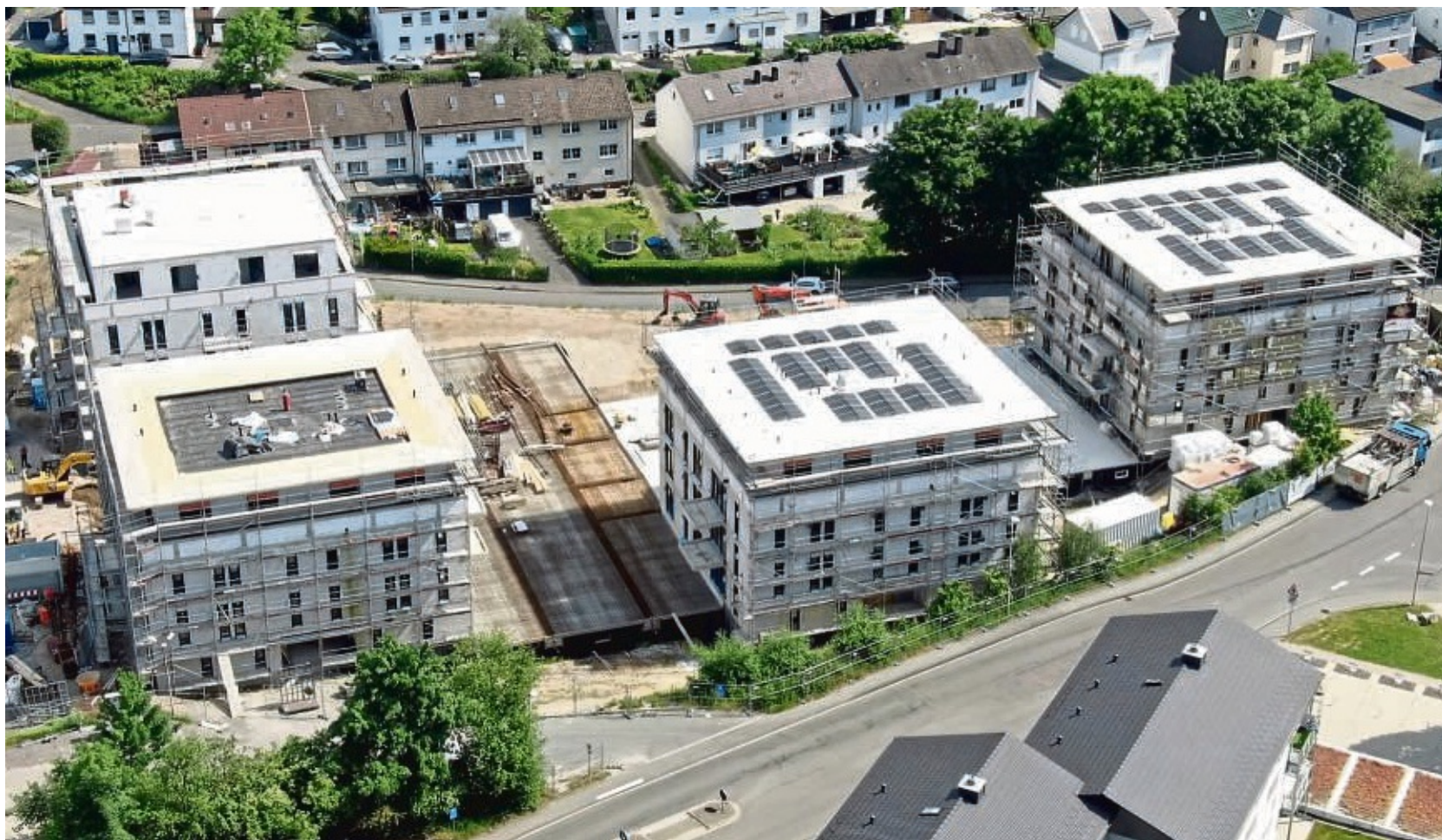
Gut zu sehen: Auf den beiden Gebäuden rechts wurden die Fotovoltaikanlagen bereits installiert.
